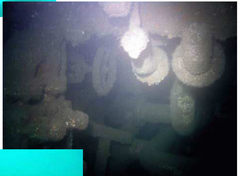
Salle des machines
